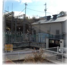
大鳥居発電所
